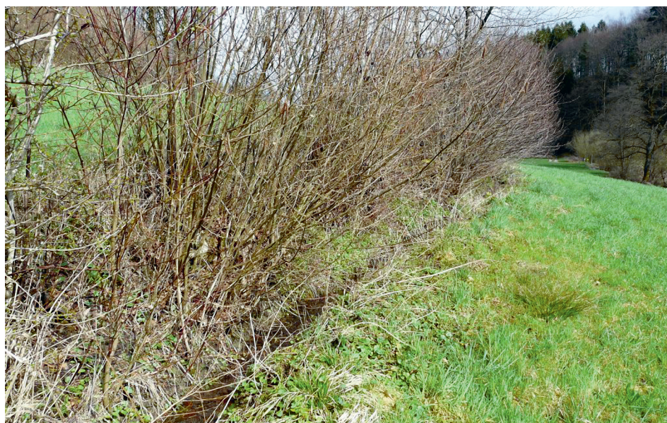
Der bestehende Entwässerungsgraben ist stark eingewachsen, weist jedoch noch wenige feuchte Stellen auf.
